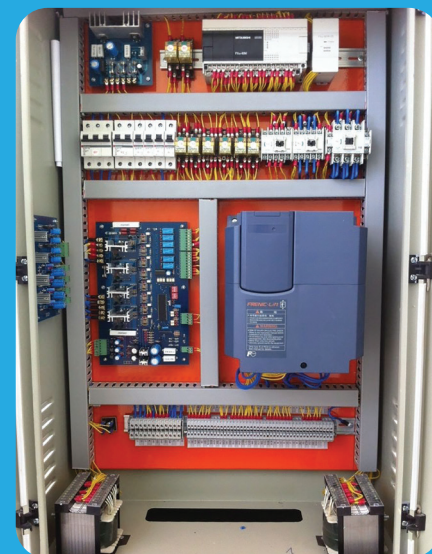
Tủ điện điều khiển PLC
